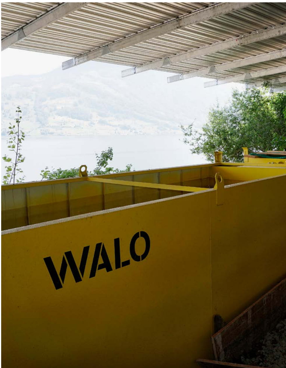
L'eau nécessaire pour le nettoyage au jet à haute pression est stockée dans deux bassins de 40 m 3 .
