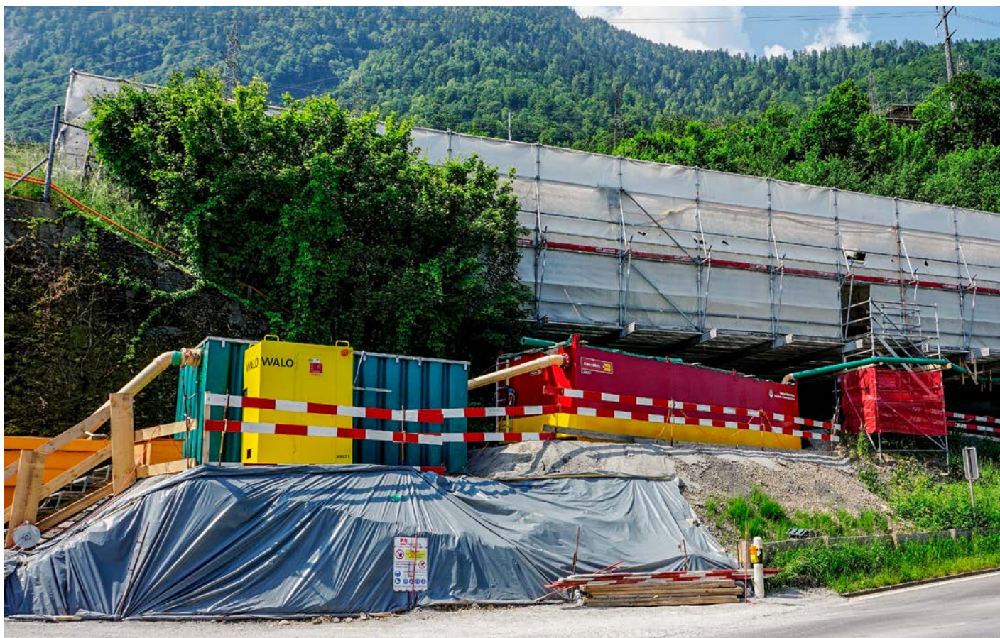
Une IPE se compose d'un bassin de décantation (rouge), d'un bassin de neutralisation (vert) et d'une cabine de commande (jaune). Sur ce chantier, un bac filtrant supplémentaire (tout à gauche) est utilisé pour collecter les matières fines.
