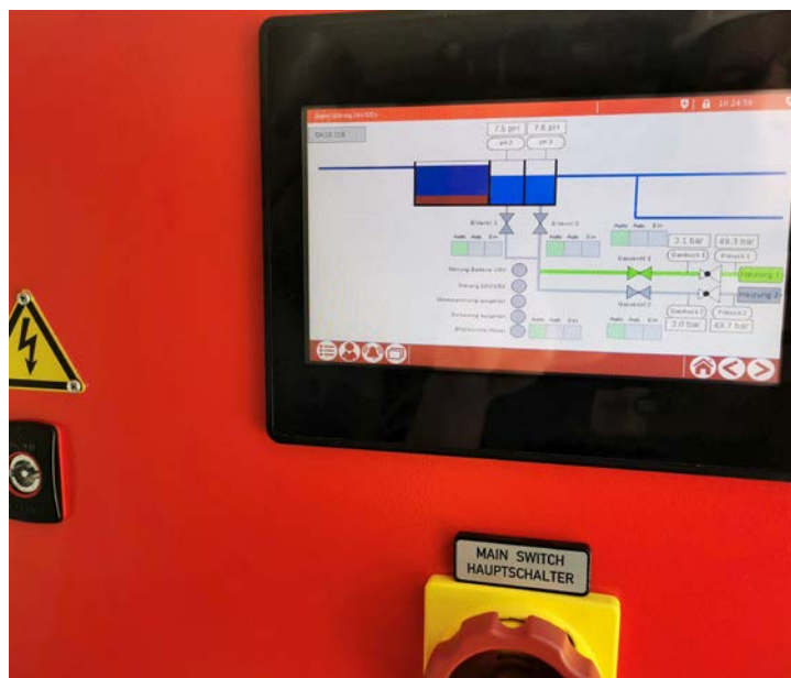
En plus du pH et de la tension, la pression du gaz est également contrôlée dans la cabine de commande.
