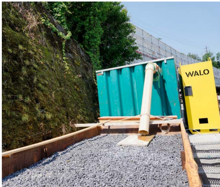
Grâce à ce bac filtrant rempli de gravier, même les dernières matières fines qui troublent l'eau sont retenues.
