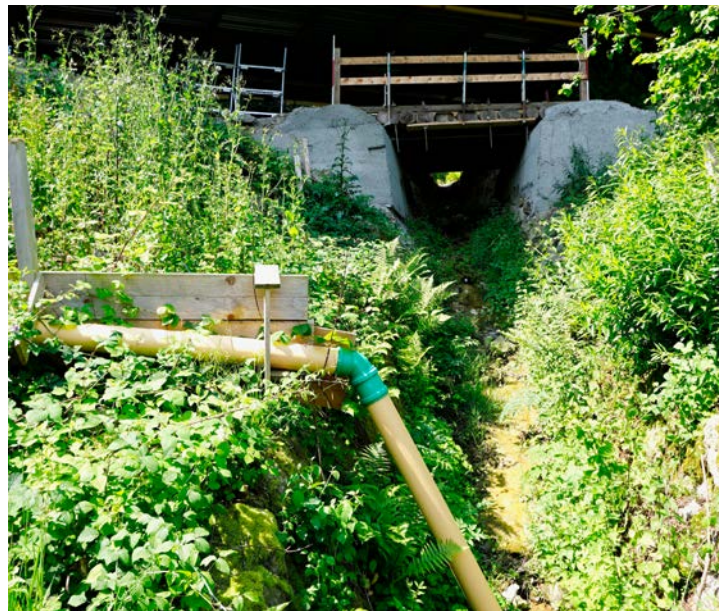
Les eaux usées nettoyées s'écoulent par un puits dans le lac de Zoug.
